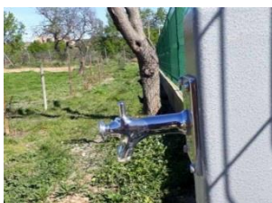
Point d'eau potable
