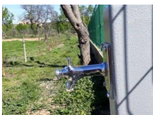
Point d'eau potable, WC publics
