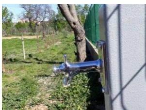
Point d'eau potable, WC publics
