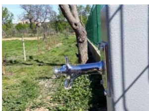
Point d'eau potable
