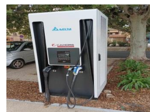
Borne recharge véhicules électriques
