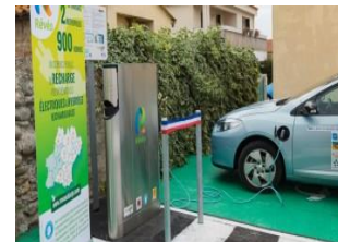
Borne recharge véhicules électriques
